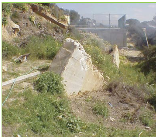
Vista general y estado después del deslizamiento de tierras
