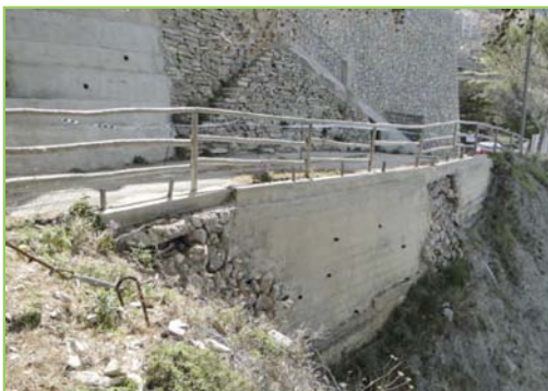
Estado después del movimiento del muro de contención
